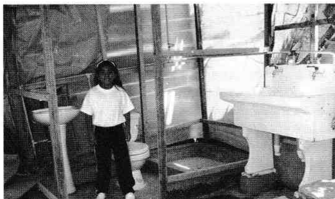
FOTO: AAHH Villa Victoria, Villa el Salvador: aparatos sanitarios instalados, conformando un espacio de aseo.
